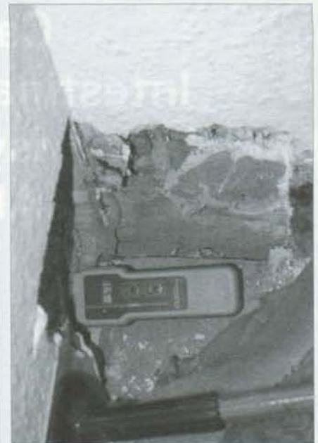
Mit einem Protimeter kann auch der Laie die Feuchtigkeit messen.
