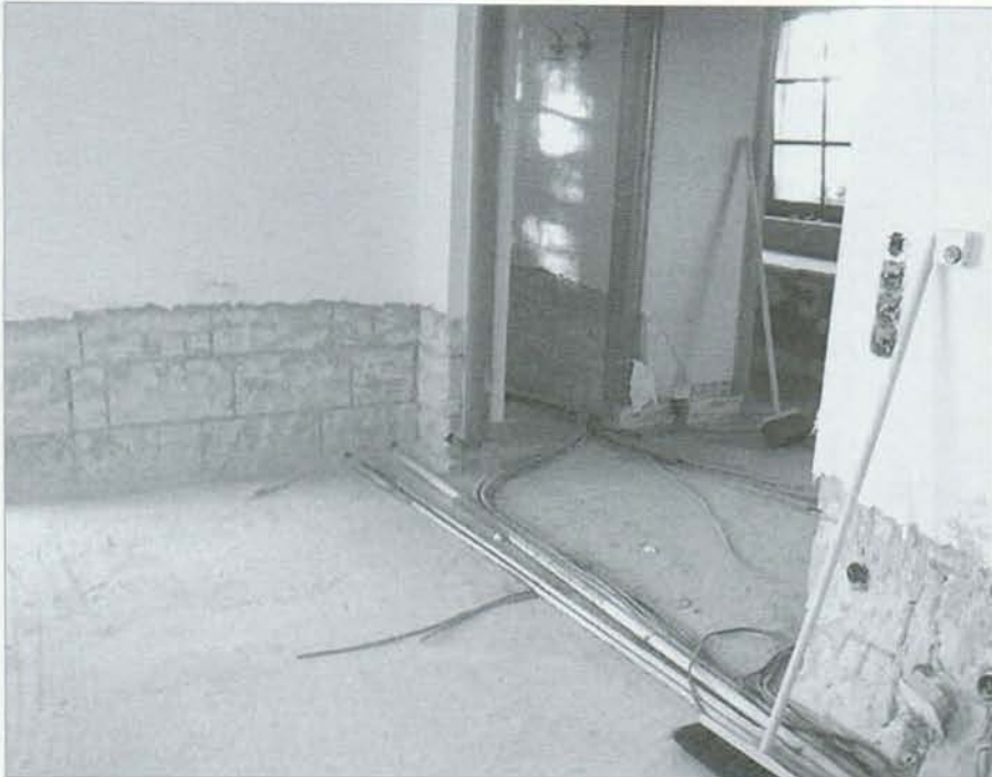
Richtige Sanierung nach einer Überschwemmung: Fußbodenaufbau und betroffenen Putz vollständig entfernen und nach der Austrocknung erneuern.
